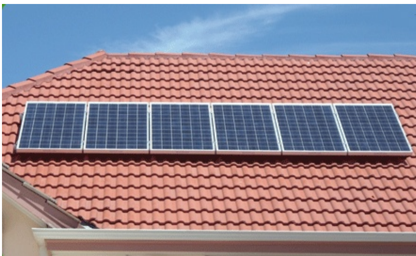
Slika 6: Fotonapetostni moduli, pritrjeni na streho stanovanjske hiše
